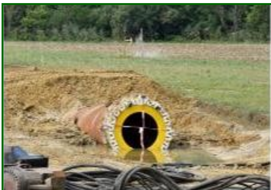
Il faut Pomper lorsque des Infiltrations Arrivent
