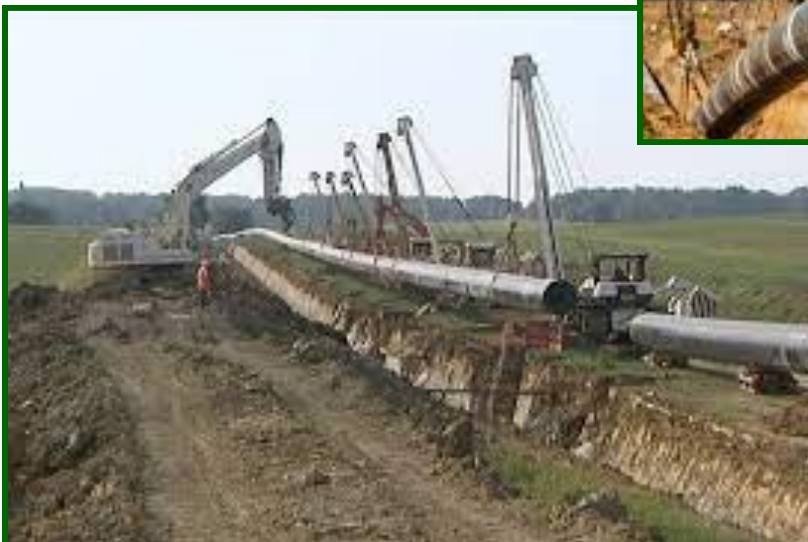
Installation des Canalisations à l'aide de Nombreuses Grues Il ne faut pas casser les soudures ni tordre le Gazoduc
