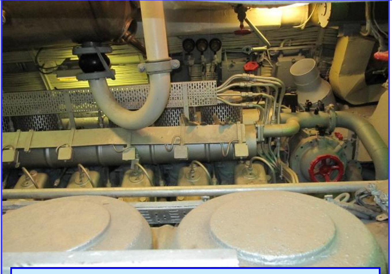
La salle des machines avec les moteurs diésel
